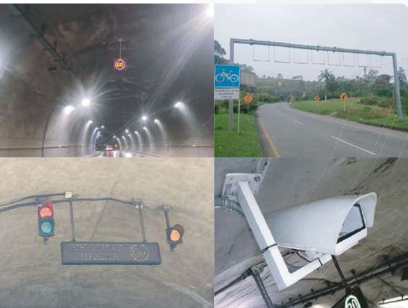
Fotografía 4. Implementación sistemas ITS en túnel Kachotis
