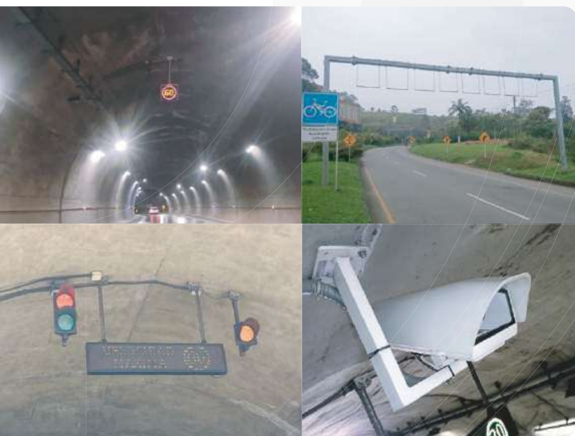
Fotografía 4. Implementación sistemas ITS en túnel Kachotis
