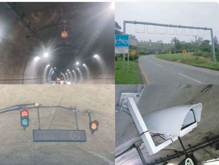
Fotografía 4. Implementación sistemas ITS en túnel Kachotis
